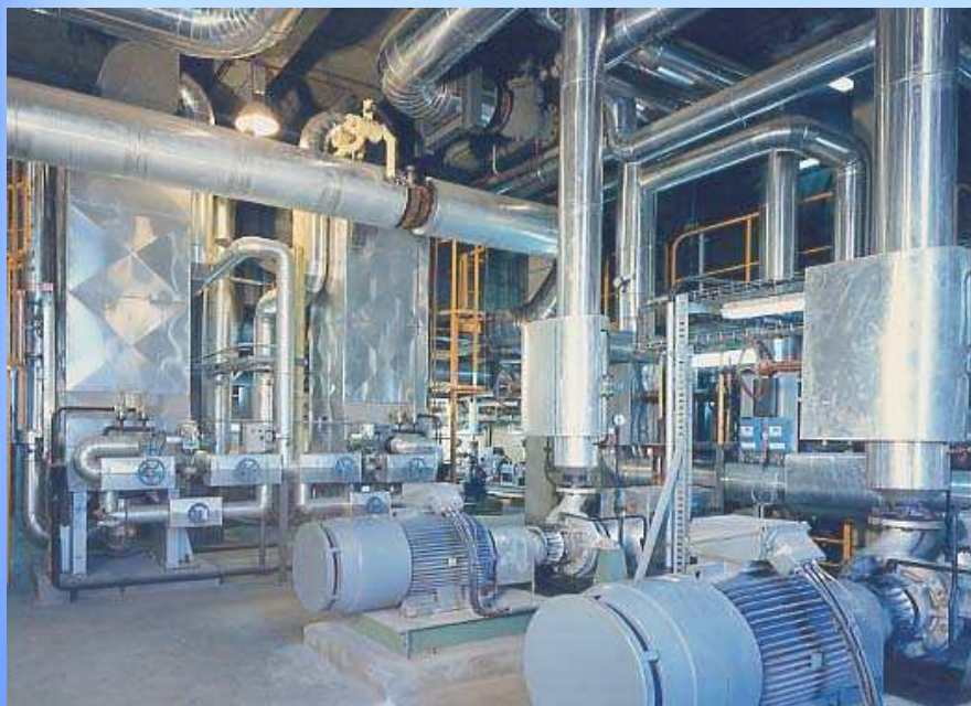
Échangeurs réseau, Lyon-Sud
